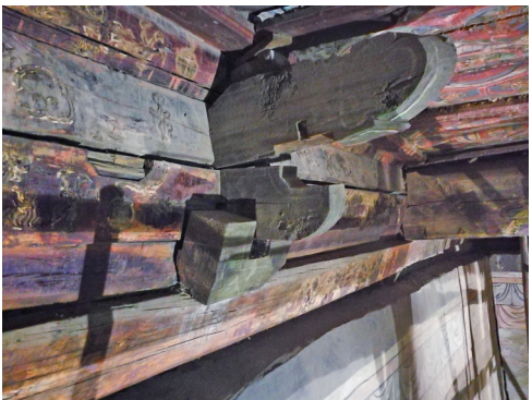
佛殿三层后檐檩、斗拱、拽枋、平板枋内翻
